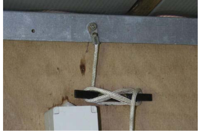
Vue sur la corde nylon fixée sur une cosse électrique
